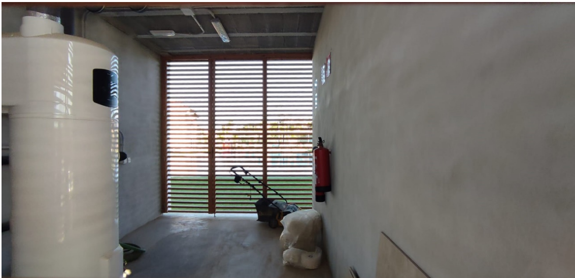
Quartet a ubicar inversor i quadres de AC i DC i a on hi ha el subquadre a connectar.
